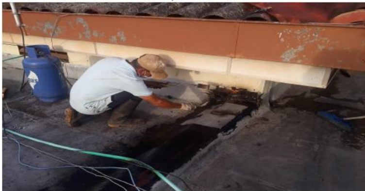
REVISAR ESTADO DE REFUERZOS DE PAREDES, VIGAS Y BARANDAS.
