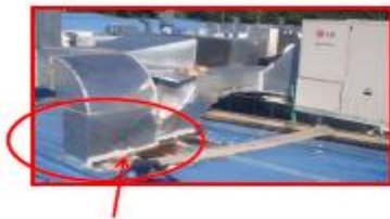
Rompimiento laminas cubierta
